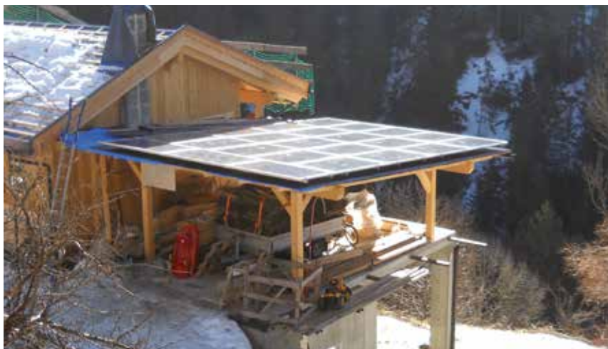
Elpo | St vigil enneberg - Włochy Instalacja: 5,29 kW | System wkrętów dwugwintowych
